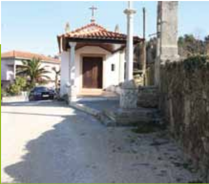
Areias de Vilar - Pavimentação da Travessa da capela de Santa Maria Madalena
